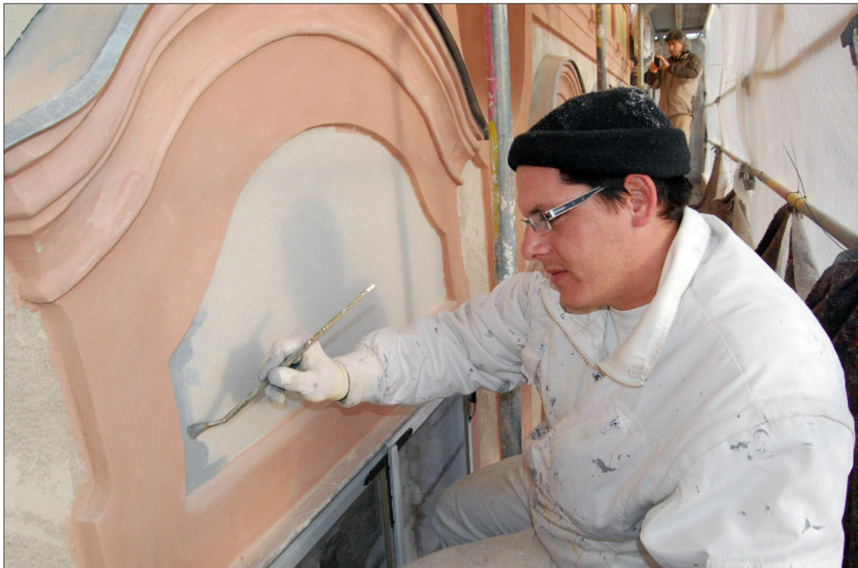
Auf den noch feuchten Putz bringt Christoph Hirsch von der Burghauser Firma Kreil die Farbe auf. – F.: rw
