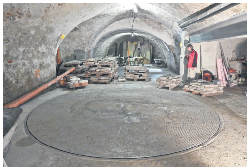
Die geniale Parklösung. Im Baumeisterhaus gibt es sechs Stellplätze. Eine Drehscheibe sorgt dafür, dass jeder Parker nicht rückwärts, sondern immer vorwärts herausfahren kann. (Foto: Kaiser)
